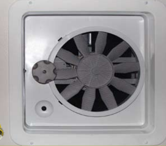
High Output Fan in Bedroom
